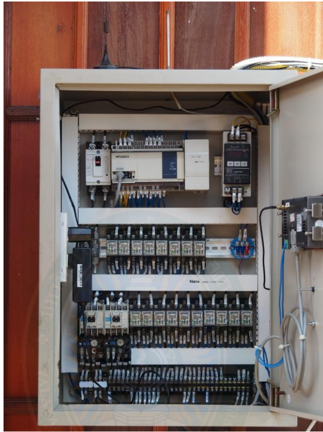
ภาพที่ 41 ชุดอุปกรณ์ระบบควบคุมระยะไกล
