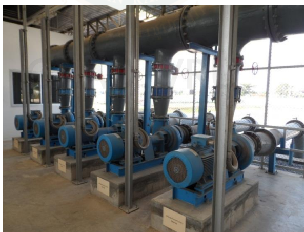
ภาพที่ 2.2 เครื่องสูบน้ำดิบ (Raw Water Pump)
