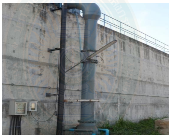
ภาพที่ 2.3 การวางท่อส่งน้ำดิบบริเวณด้านข้างถังตกตะกอน
