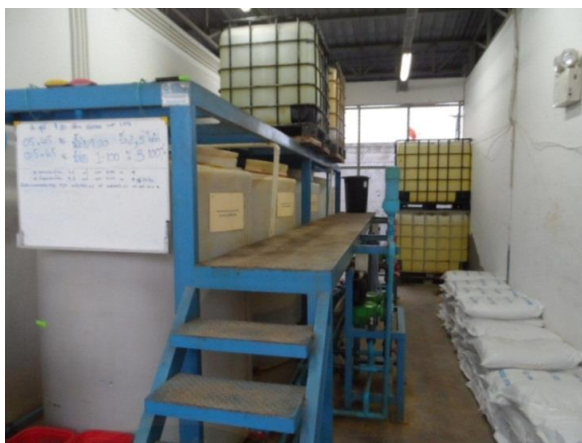
ภาพที่ 2.4 ห้องจ่ายสาร PAC และสารโพลีเมอร์
