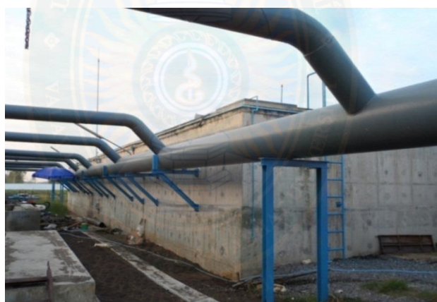
ภาพที่ 2.10 ท่อรับน้ำกรองเข้าถังเก็บน้ำใส
